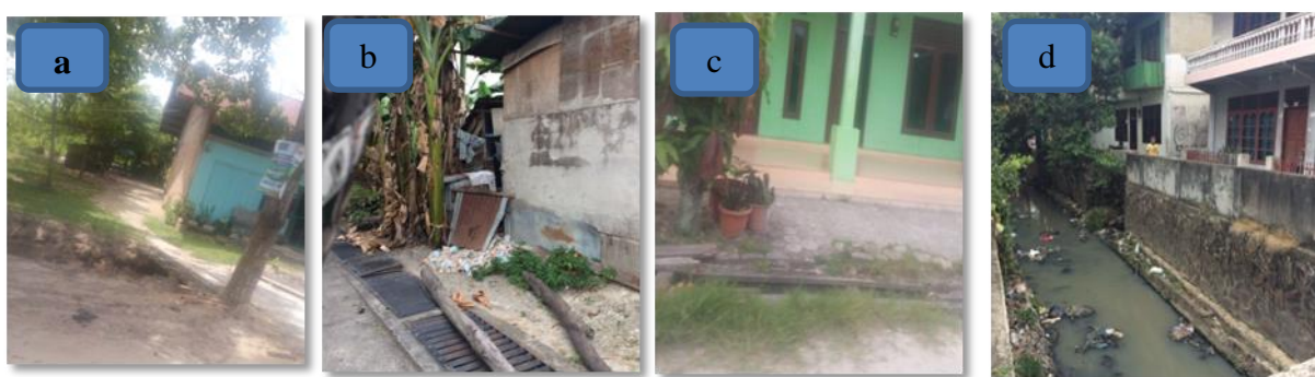
Gambar 7. Kondisi drainase lingkungan di beberapa kelurahan a. Drainase tidak permanen, b. Drainase yang terlalu kecil, c. Drainase permanen yang tidak terawat, d. Drainase yang dangkal dan ditumpuki oleh sampah.
